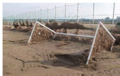
多摩川河川敷の復旧に半年かかる見込み
