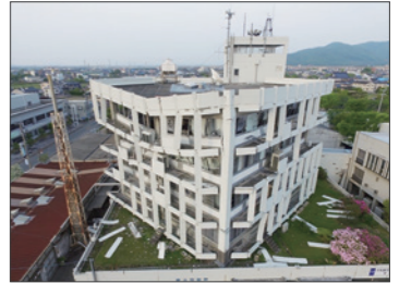
半壊した宇土市役所。BCPは未整備だった。
