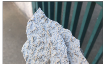
強風により剥がれ落ちたモルタル。
