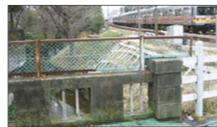
通学路上の老朽化している橋
